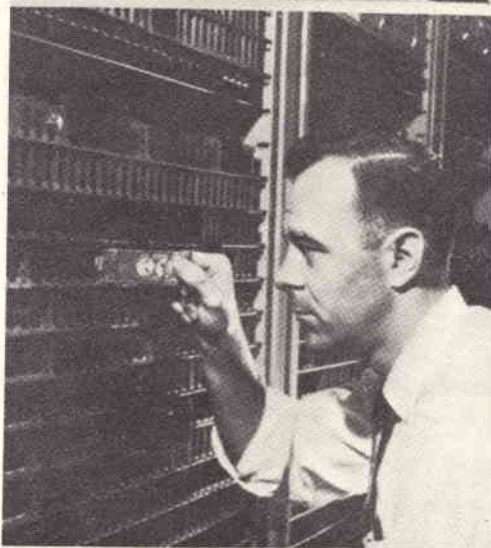
Operazioni di controllo da parte di tecnici nella nuova centrale telefonica di Morris (Illinois).
